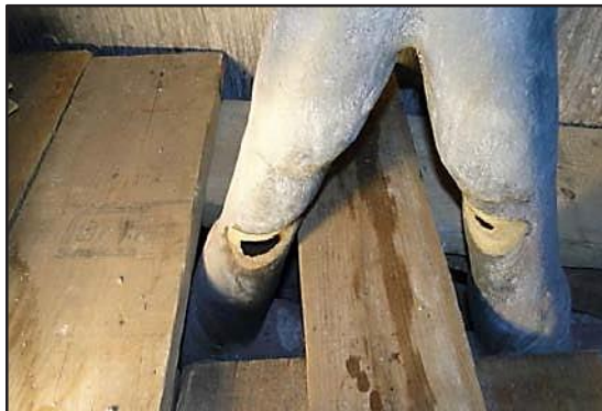
Sección dañada del colector de pulverización.
